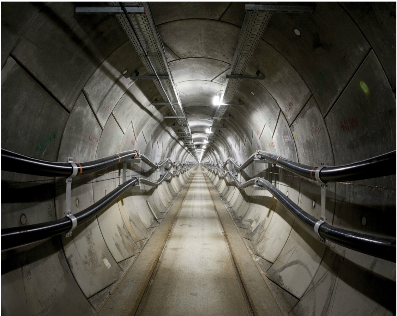
Galerie technique à Montesquieu des Albères Prise de vue des 4 câbles
